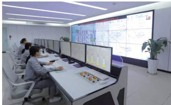
天科(荆州)制药有限公司绿色制药产业基地自控项目 Automatic control project of green pharmaceutical industry base of Tianke (Jingzhou) Pharmaceutical Co., Ltd.
